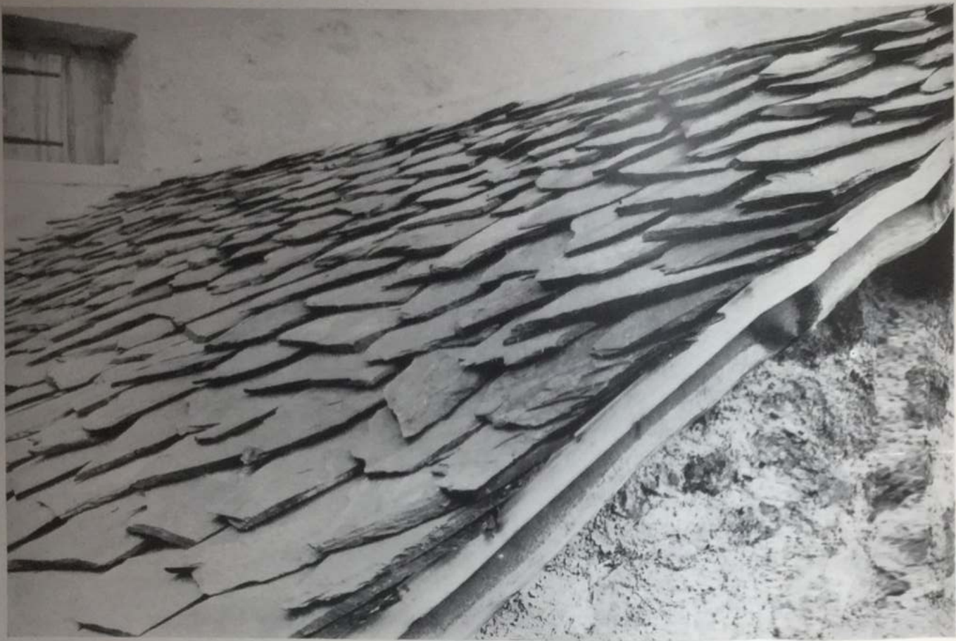
Ein Plattendach mit „ungerichteten“ Platten vorzüglich nach dem Gesetz des Wasserlaufes gedeckt. Die Spitzen der Platten, die als Tropfstellen funktionieren, kommen immer auf die Mitte des unteren Gebindes zu liegen. Die Dachneigung ist über 30^\circ und deshalb sind die Platten mit starken Nägeln befestigt.
