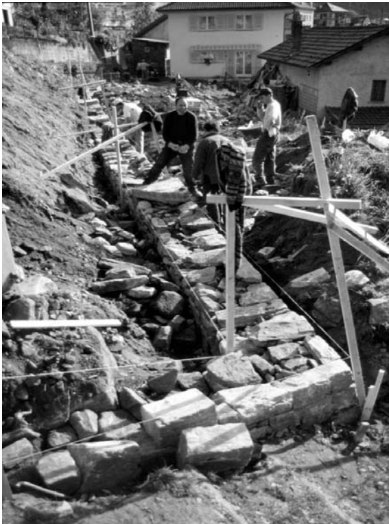
Abbildung 14: Stiftung Umwelt-Einsatz Schweiz, Bau einer Lasten tragenden Stützmauer in Verdabbio GR / Juni 2002
